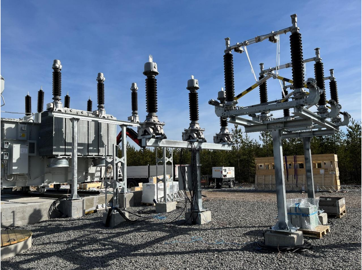
Kuva 5. Kuva muuntamosta (Neoen Renewables Finland Oy).
